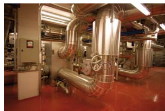
Fra kedlen bliver det varme fjernvarmevand ledt til en varmeveksler og videre til radiatorerne derhjemme.
