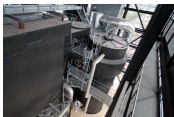
Inden røgen bliver lukket ud gennem skorstenen, bliver de skadelige stoffer fanget i posefilterne.
